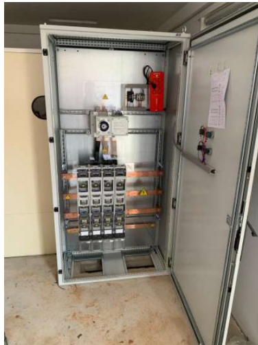
Ilustración. Envoltorio metálico del CGBT
