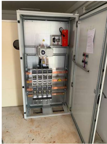
Ilustración. Envoltorio metálico del CGBT
