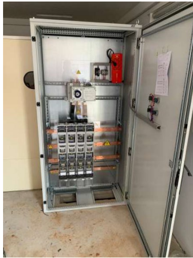
Ilustración. Envoltorio metálico del CGBT
