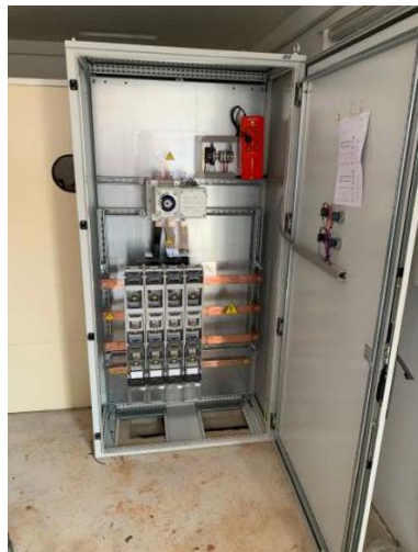
Figura 2.3.4.1. Envolvente metálica del CGBT (Fuente: Proyecto IBERSUN)
