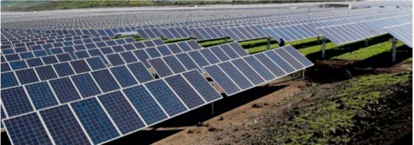
Energia fotovoltaikoa sortzeko instalazioa, AraSur (Araba)
