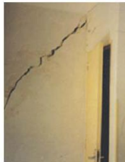
Grieta debida al asiento excesivo en la esquina de una edificación
