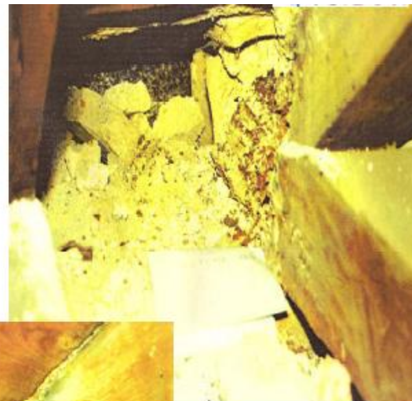
Dstrucción de la madera del empotramiento de la ceiclia por ataque por hongos
