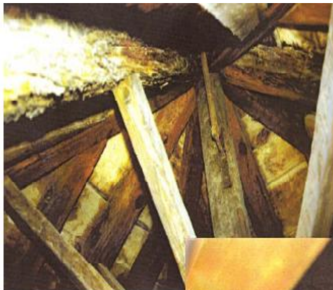
Ataque por hongos a diversos pares de la estructura de madera de la cúpula de una iglesia
