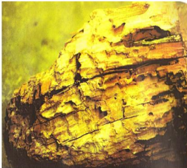
Cabeza de viga atacada por hongos y carcoma gruesa
