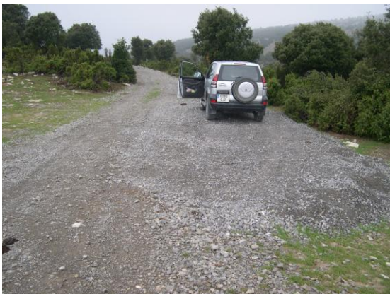
Plataforma aerogenerador nº26 antes del aporte de la tierra vegetal y la siembra.
