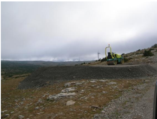
Plataforma aerogenerador nº14 antes del aporte de la tierra vegetal y la siembra.
