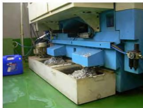
Tanque de taladrina Fuente: TEKNIKER
