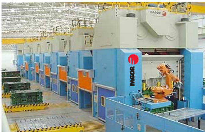
Figura 3 Línea de prensas mecánicas
