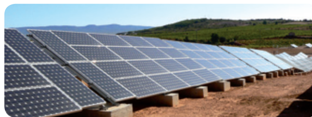
1,7 MW-ko eguzki-baratzea, Daudete de las Fuentesen (Valentzia). Ingeniaritza-enpresa honek egin du proiektua: Sistemas Sostenibles, S.L. Enpresa erakitzailea: GESENSA (Gestión de Soluciones Energéticas, S.A.)
