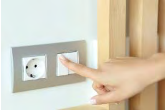
Ejemplo de interruptor y toma de corriente contrastados con pared
