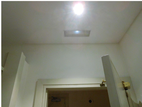
Alumbrado de emergencia en puerta de cabina
