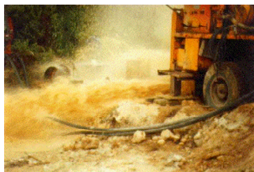
Salida del agua evacuada a la balsa de lodos
