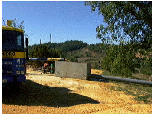
2º Bombeo Zikujano-B, Qb= 12 l/s
