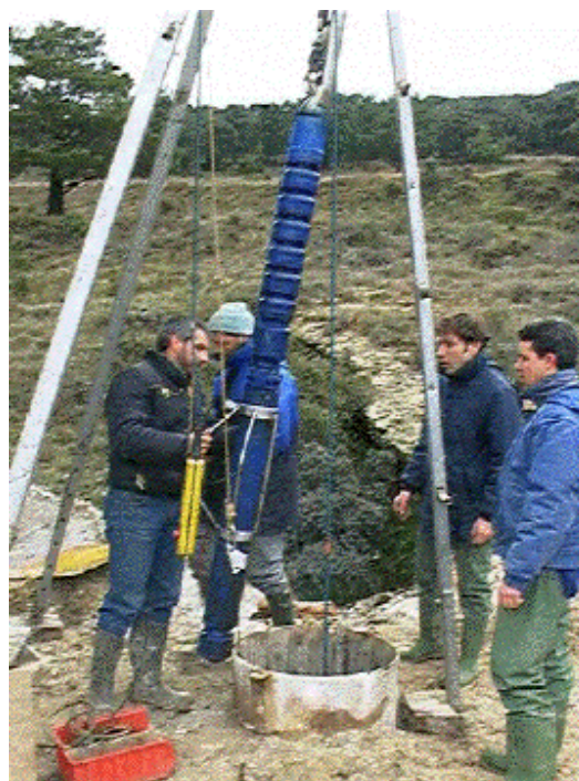
Instalación del equipo de bombeo para la realización de los registros de producción en el sondeo OSMA-B
