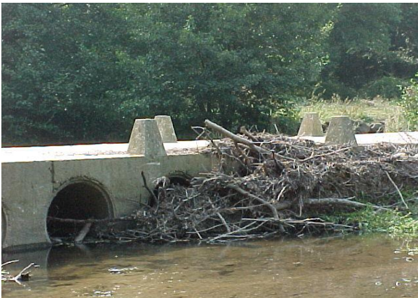
En este tramo se ha localizado una presa. El agua parece filtrarse por las fisuras que existen en el muro
