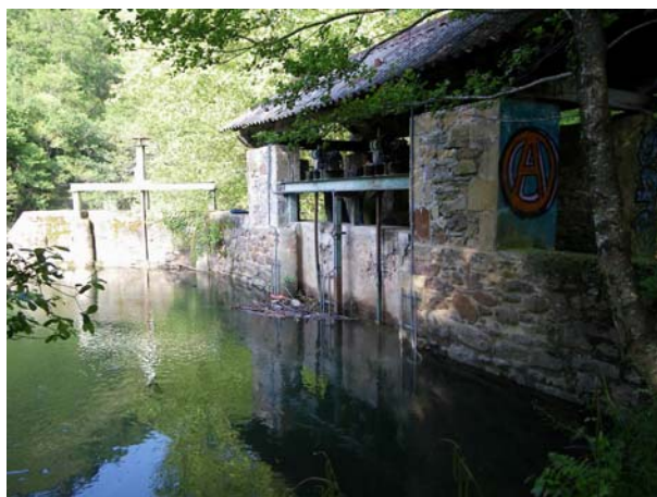
Foto 1. Barrera sónica en la toma del canal
