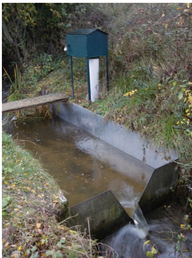
Figura 7 Aspecto de la estación de aforo SA25-Arreo Entrada (Vertedero Triangular 60°).
