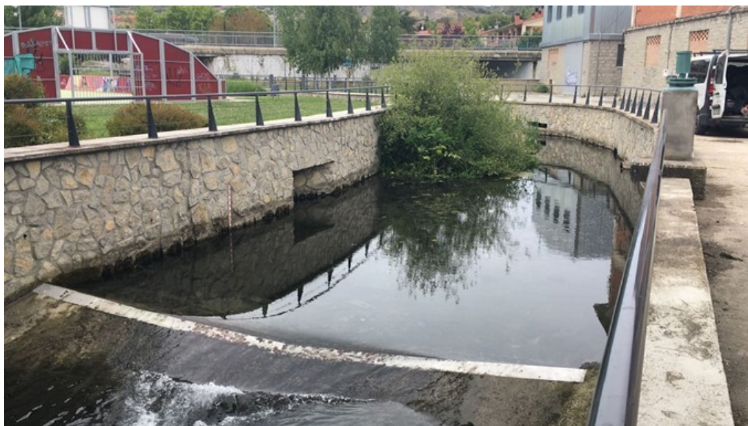
Figura 1 Estación de aforo SA04-Nanclares de la Oca.
