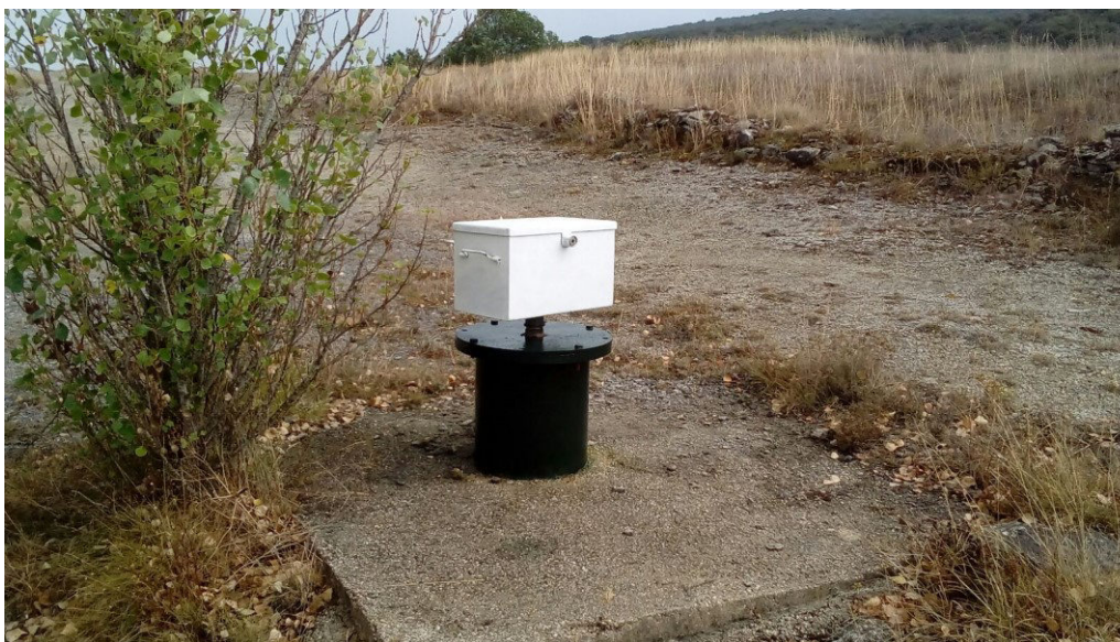
Figura 2 Estación de control piezométrico SP14-Sondeo OSMA-C.
