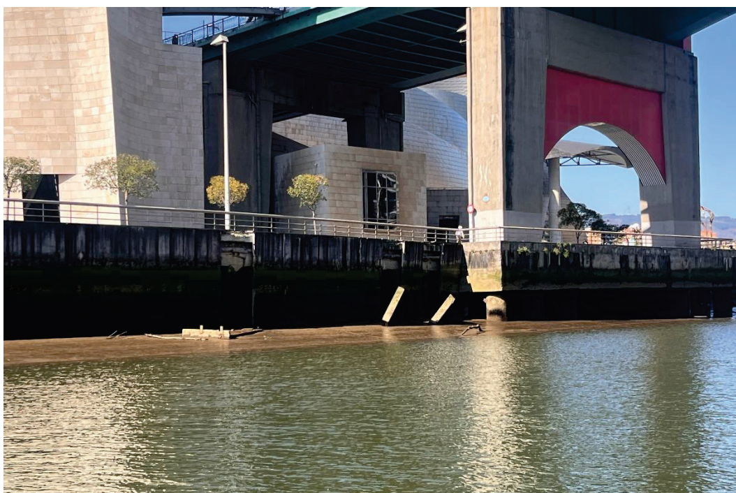
Vista del muelle en la Zona 1A con alguno de los faldones caídos.
