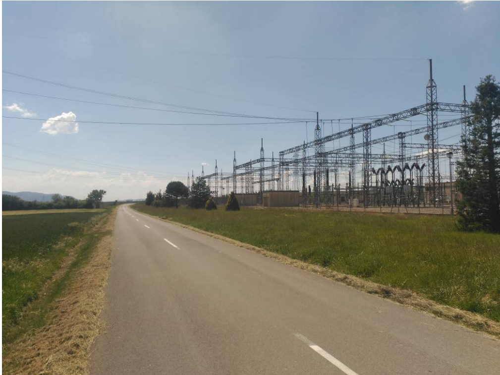
Fotografía 1. Subestación de Vitoria
