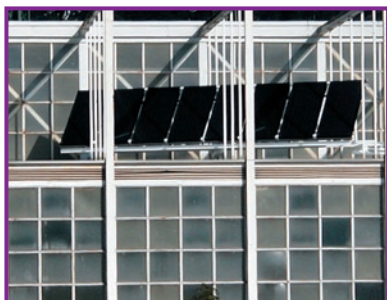
Los acumuladores de energía solar, montados sobre el tejado del frontón.
