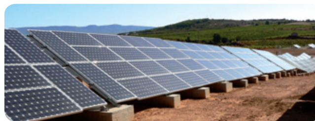
Huerto Solar de 1,7 MW en Caudete de las Fuentes (Valencia). Proyecto desarrollado por la Ingeniería: SISTEMAS SOSTENIBLES, S.L. Empresa Constructora: GESENSA (Gestión de Soluciones Energéticas, S.A.)
